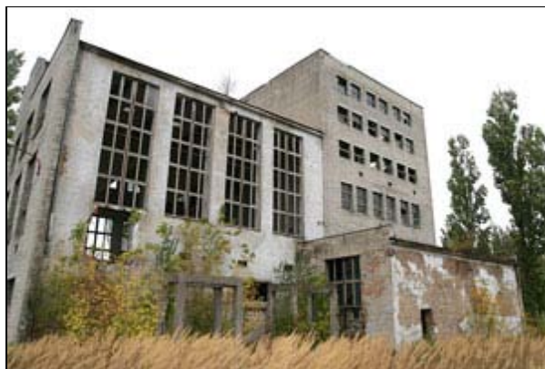
Dzisiaj do niebezpiecznych, rozpadających się budynków po Bydgoskich Zakładach Gazowniczych może się dostać każdy. Czy ten teren można zrewitalizować? Fot. Radosław Sałaciński
